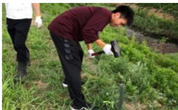
図 1 水処理施設用太陽光パネル設置の様子
